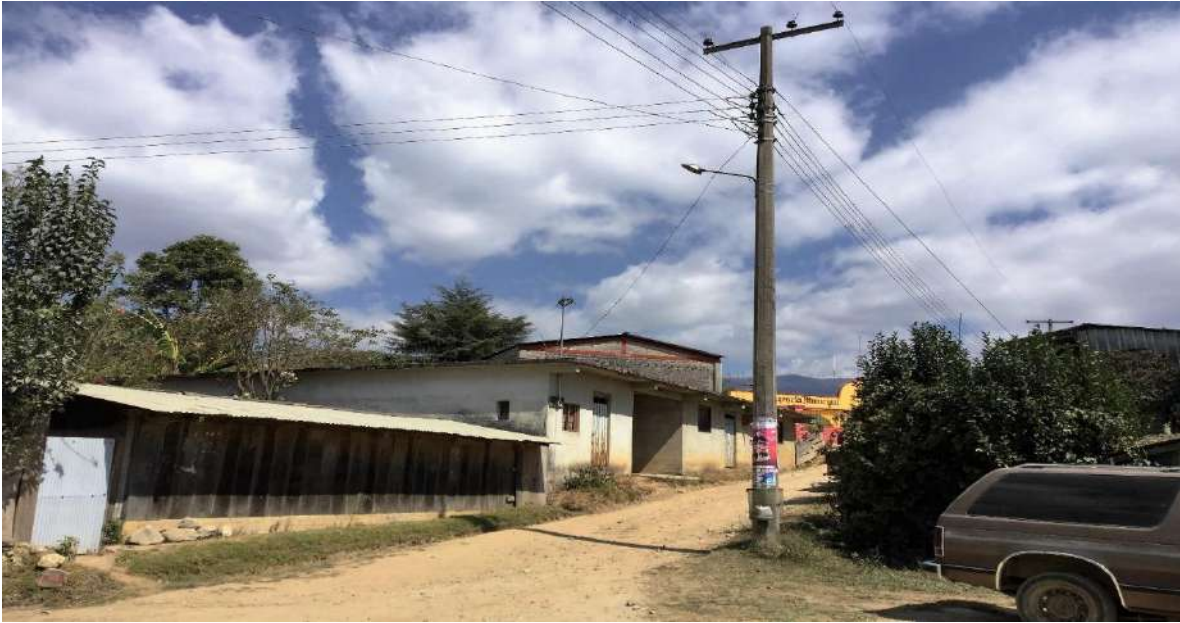
Fotografía 6: Poste de luz eléctrica sin funcionamiento. Tomada por: Javier Segura, Febrero 2017
