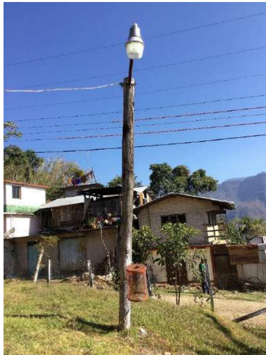
Fotografía 15: Luminaria, sin funcionamiento. Tomada por: Javier Segura, Febrero 2017
