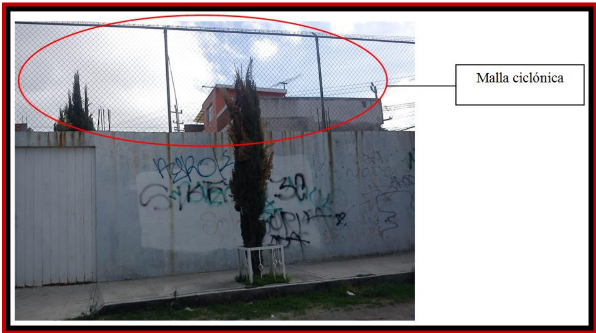
Fotografía 12. Aquí encontramos que en esta vivienda solo emplearon malla ciclónica como medida de seguridad contra el delito.
