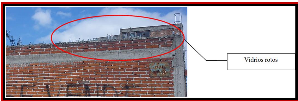
Fotografía 6. Lo que se observa en esta fotografía es algo que ya casi no se usa, vidrios rotos en las bardas.
