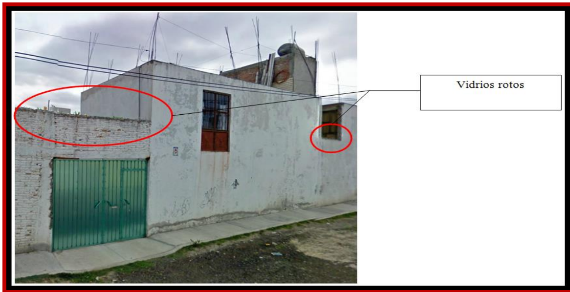
Fotografía 7. Aquí se observan vidrios rotos en los muros más bajos de la vivienda.
