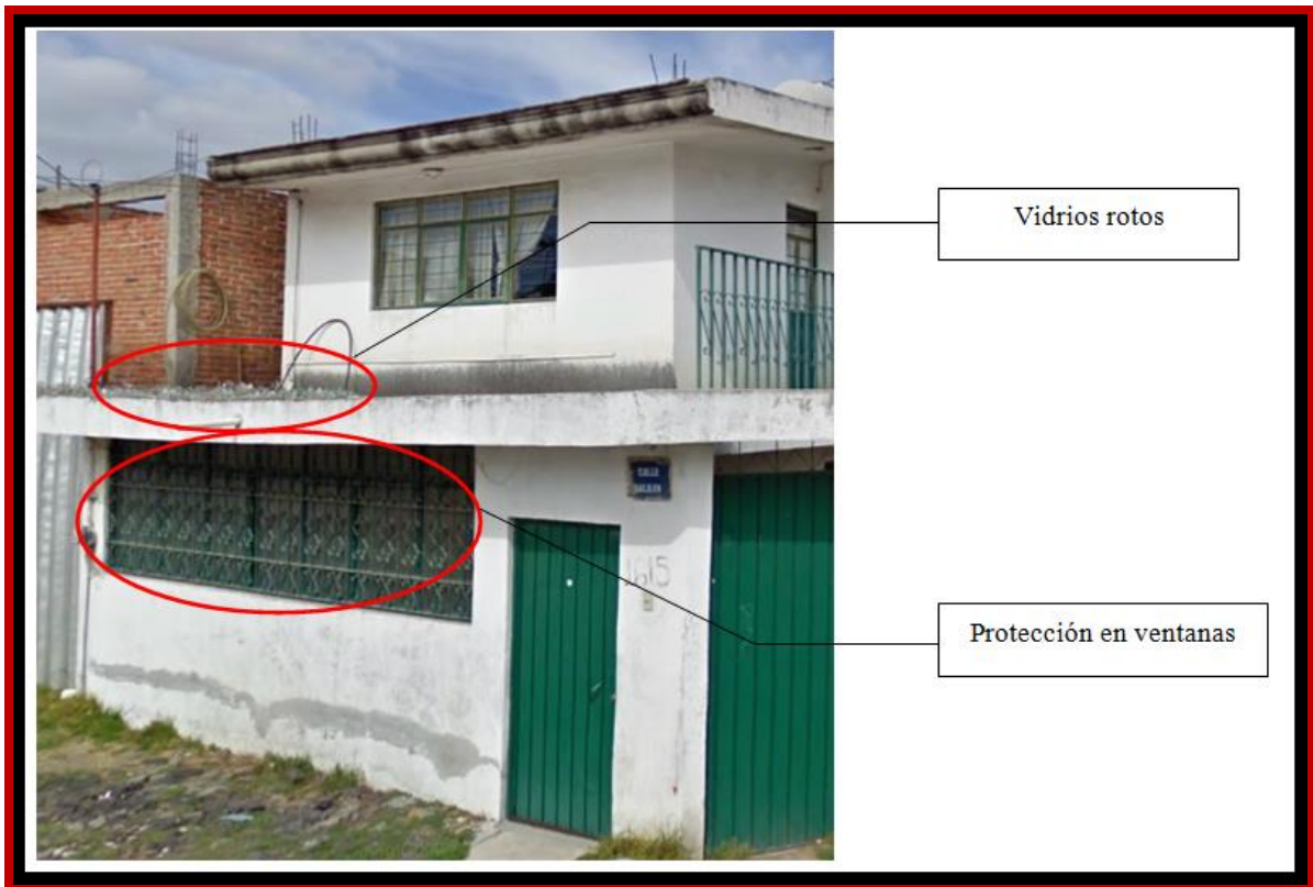
Fotografía 20. En esta vivienda emplearon protección en las ventanas y vidrios rotos como medida de seguridad.
