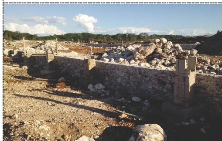
Fotografía 11.- Conjunto de dados colados, cimbrados con madera de pino de segunda y concreto f_c=200 \text{ kg/cm}^2 hecho en obra.
