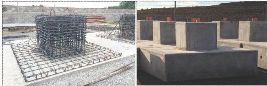
Fotografía 1.- Armado de zapata y dado, acorde a especificaciones de proyecto (imagen esquemática, no corresponde al caso de estudio) Fotografía 2.- Zapata y dado colados en planta con concreto f_c=2500 Kg/cm 2 (imagen esquemática, no corresponde al caso de estudio).
