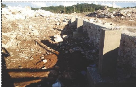
Fotografía 12.- Zapata y dado colados, con concreto f_c=200 \text{ kg/cm}^2 hecho en obra.
