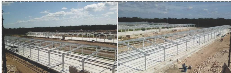
Fotografías 13 y 14.- Colocación de 31 marcos de acero a base de IPR de 8"x8" (columnas), IR de 8"x10" (trabes) y polines 5ZE14.
