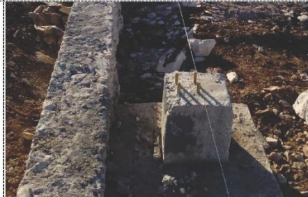
Fotografía 10.- Errores de colado de dados, al emplear cimbra de madera y concreto hecho en obra (desprendimientos de concreto).
